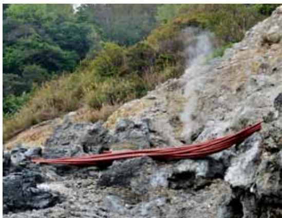
溫泉配管 Hot Spring piping
