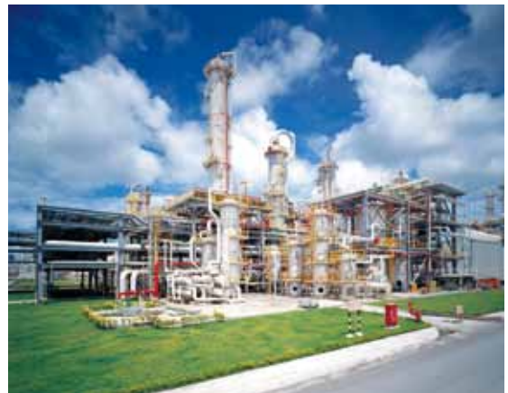
石化工廠 Petrochemical plant
