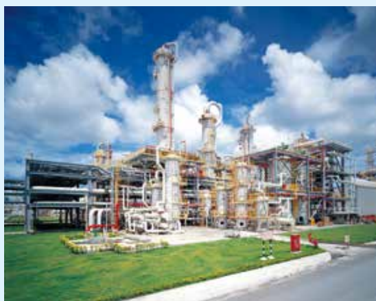
石化工廠 Petrochemical plant
