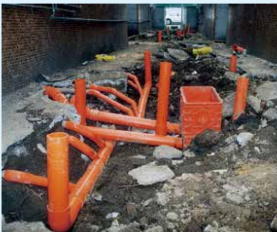
下水道排水配管 Sewer Engineering
