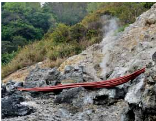
溫泉配管 Hot Spring piping
