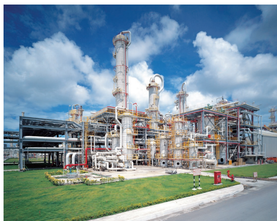
石化工廠 Petrochemical plant
