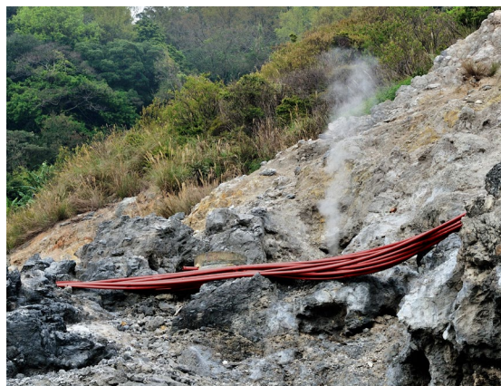
溫泉配管 Hot Spring piping
