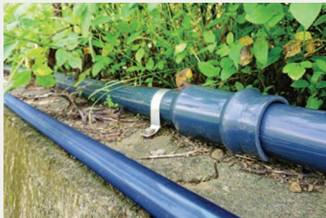
山區簡易自來水管路
