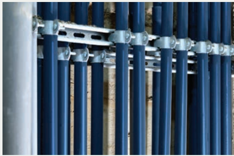
建築用自來水管路、揚水管路
