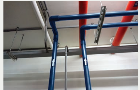
汙水動力流管路配管
