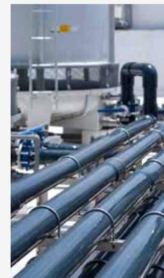
冷凍空調工程 Air Conditioning project
