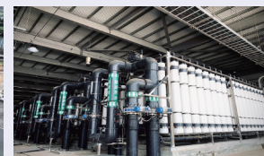
超濾產水設備
